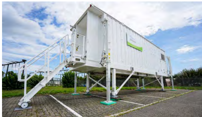
Außen schlicht, innen neueste Technik. Pascal Born nimmt in der mobilen Container-Schaltanlage die Leittechnik in Betrieb.
