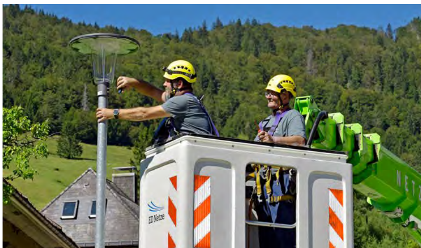
Straßenbeleuchtung: Das ED Netze-Team sorgt für effiziente LED-Technik.
